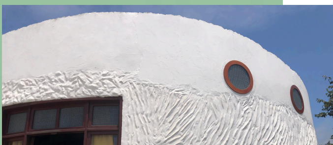
Cámaras de ventilación natural
