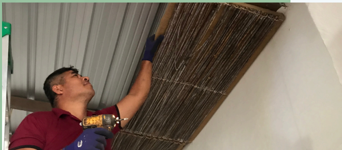
Sistema de aislamiento térmico con vegetación introducida
